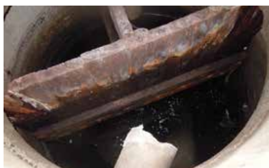
Mellanvägg i trä, risk för slamflykt.
